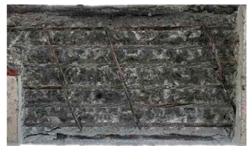
写真 1 PC 鋼線の破断状況例
