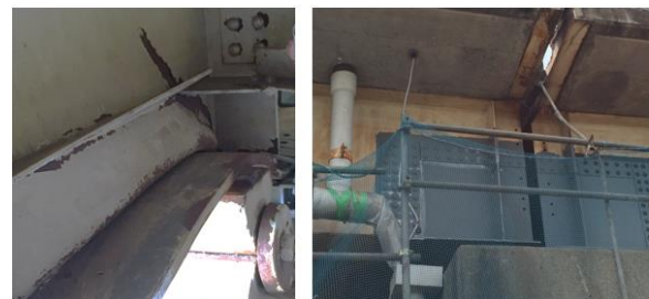
図 1 地震時の主桁の損傷・補修
