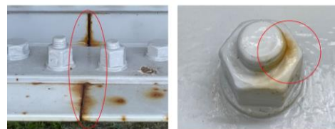
写真 1-1 鋼橋の腐食損傷の例
