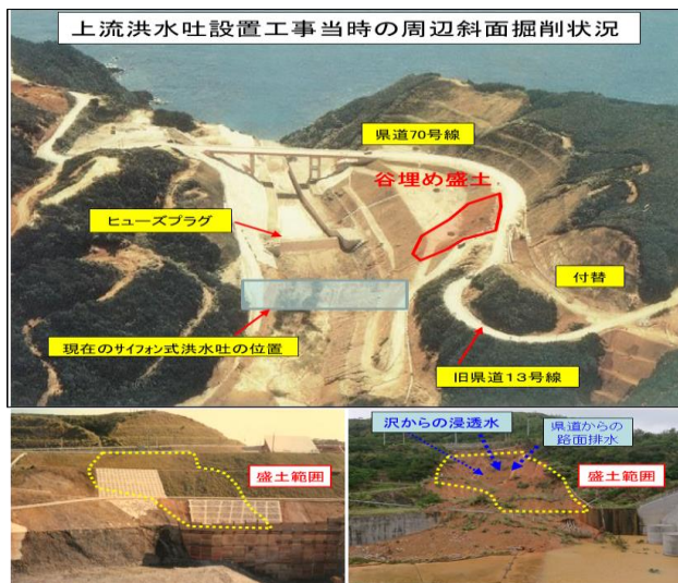
図-3 上流洪水吐設置時（1972年）の崩壊箇所の状況
